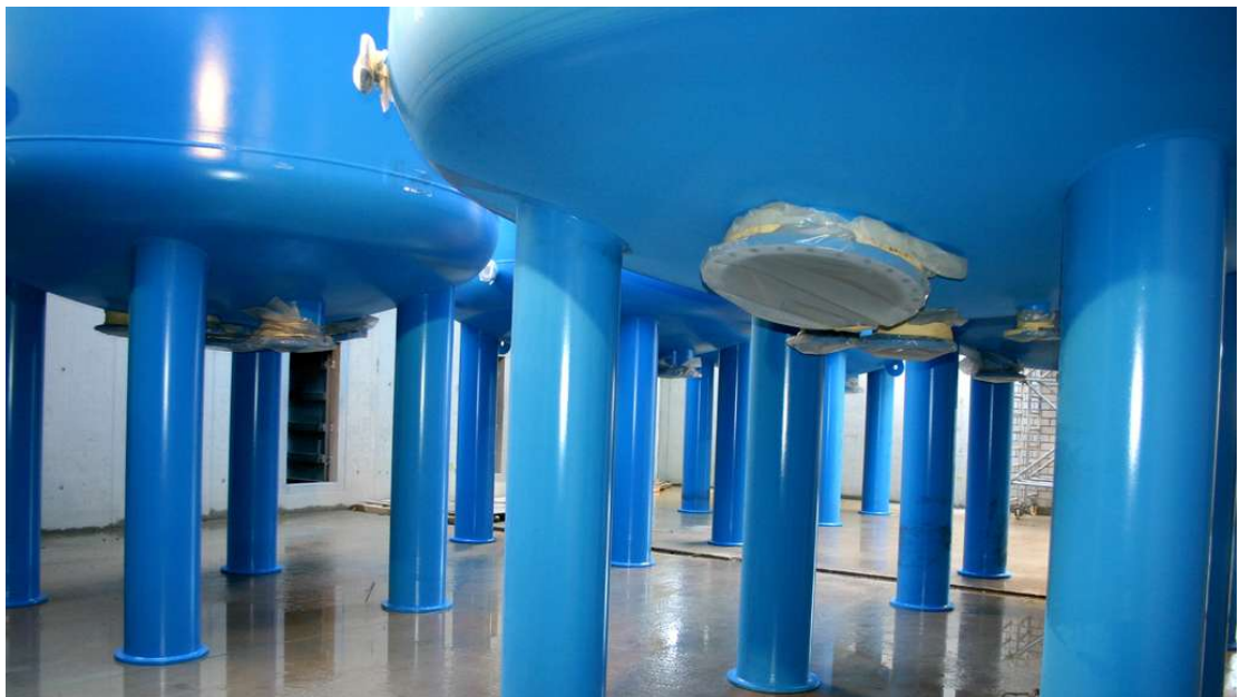
Einbau der Filterkessel im Wasserwerk Hennesee
